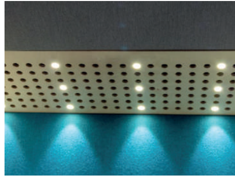
Iluminación encastrada y sistema de ventilación.
